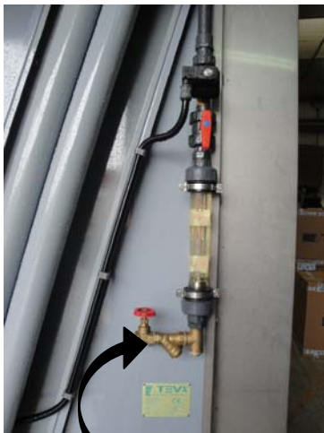
Imagen 6 Image 6 Entrada agua de red Network water inlet
